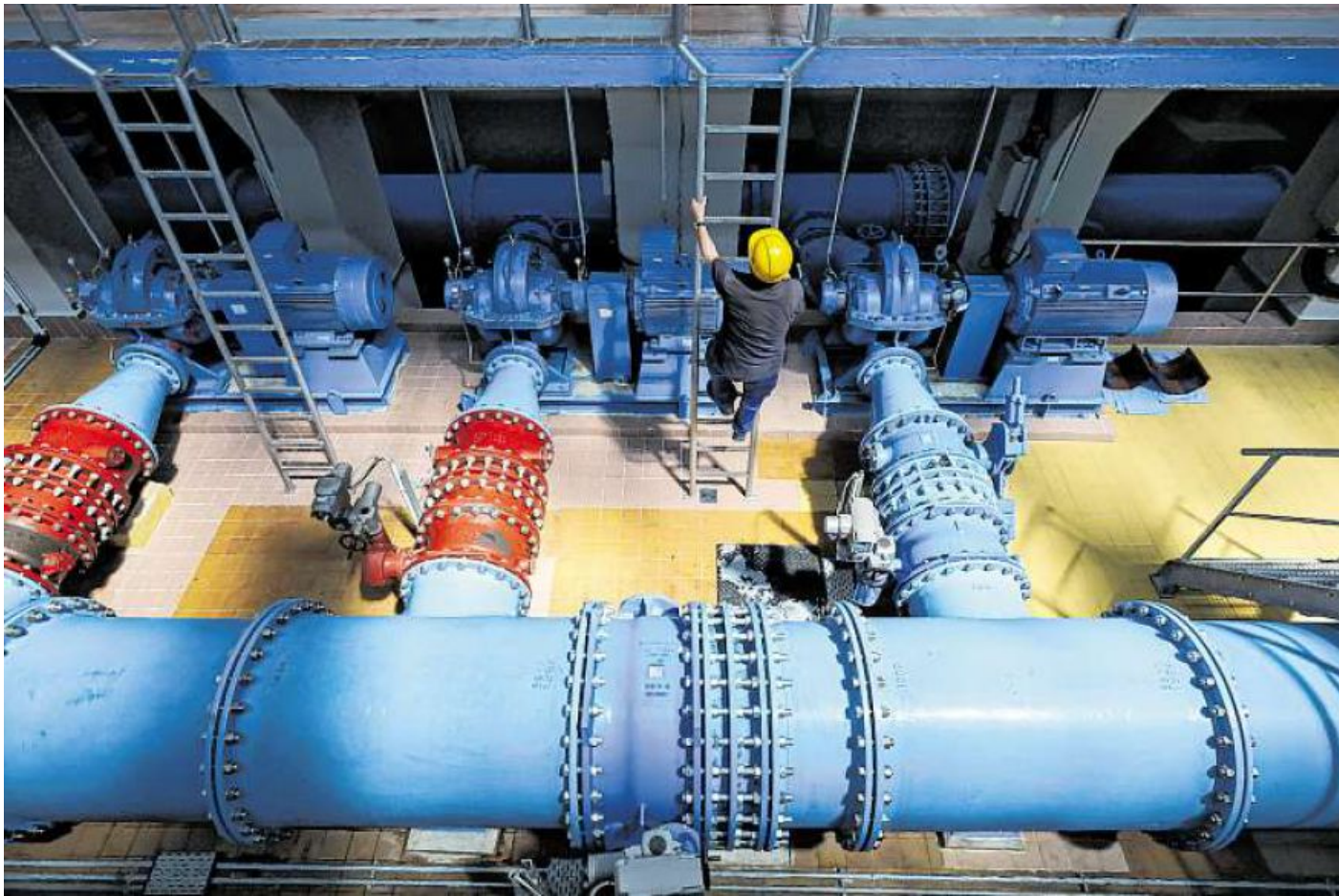
Neue Jobbezeichnung: Fachkräfte für Wasserversorgungstechnik, wie hier in einer Wasserversorgungsanlage in Leipzig, heißen in Zukunft Umwelttechnologien für Wasserversorgung. FOTO: JAN WOITAS, MAG
